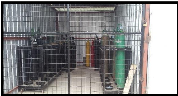
BODEGA - ALMACENAMIENTO DE GASES
